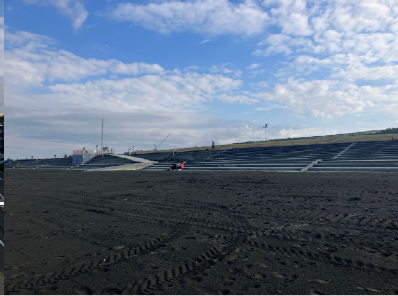
図-8 津波避難に伴う障害（高台）
